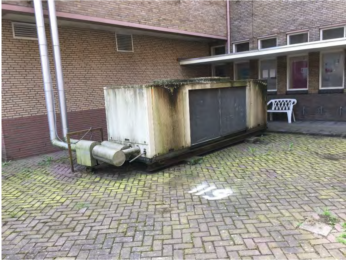
Binnenzijde open plaats van gebouwen, verwarmingsketel, nabij boring 119
