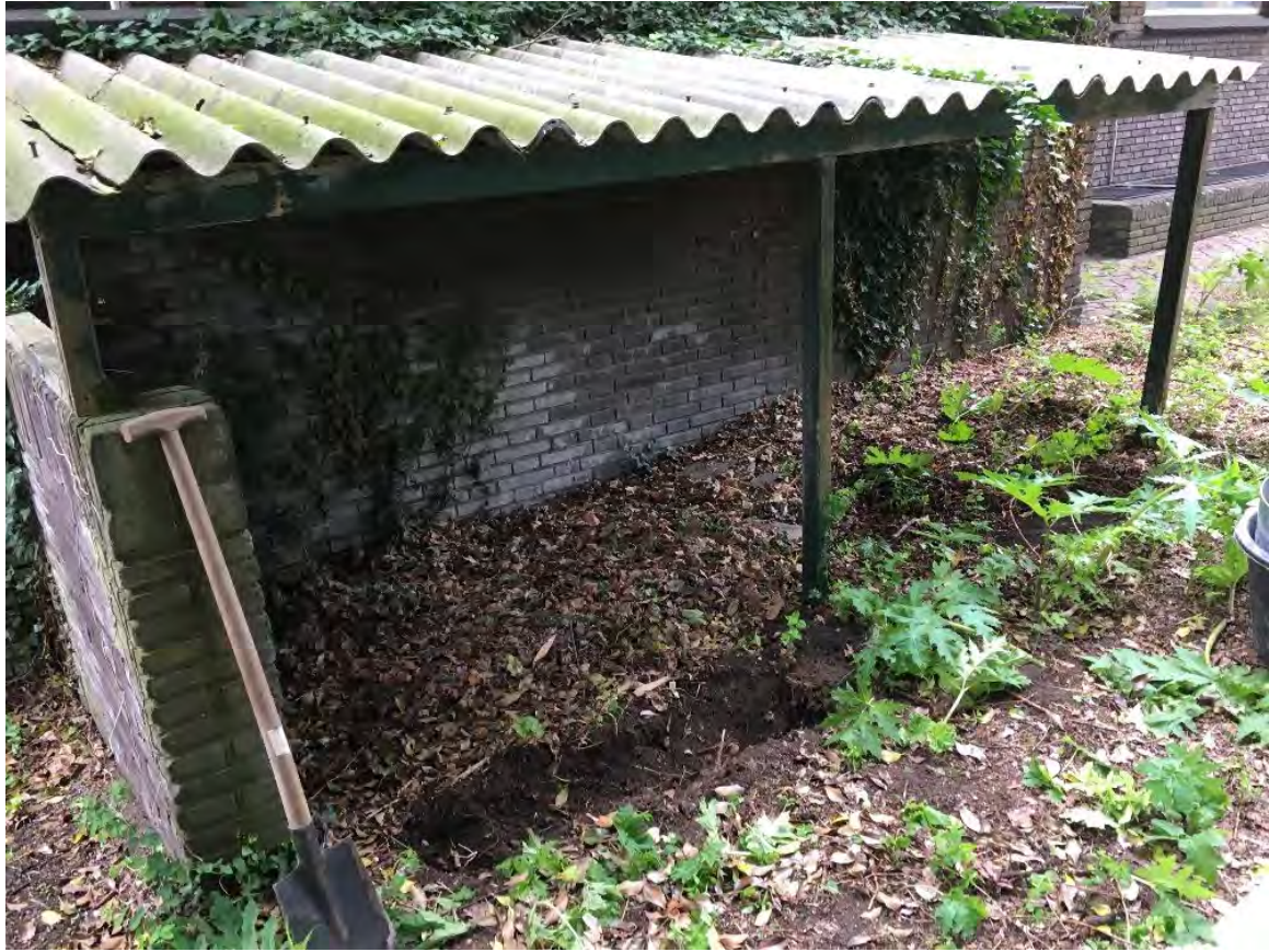
Asbest dak zonder dakgoot-druppellijnonderzoek 0,0-0,10 m-mv
