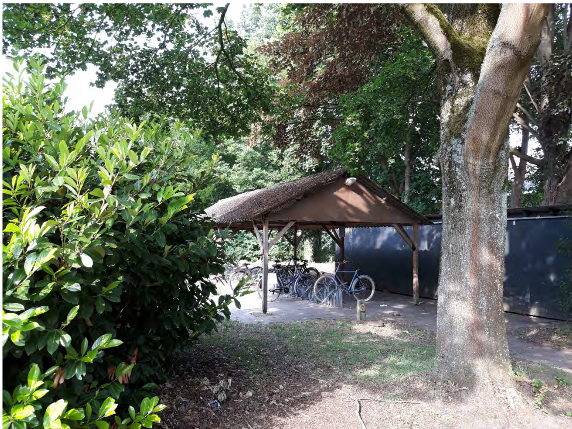
Fietsenstalling met asbestgolfplaten dak zonder dakgoot nabij boring 118, onderliggend klinkers
