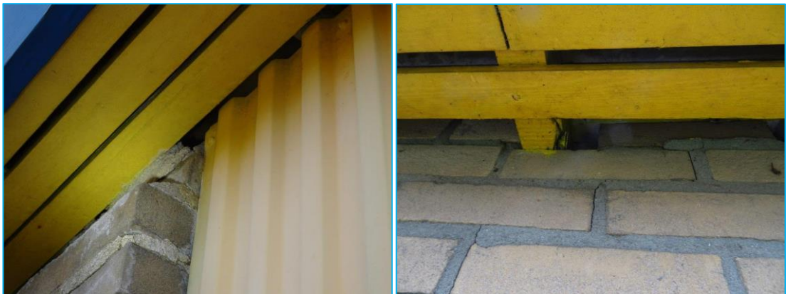
Foto's: Openingen school A en fietsenstalling die toegang kunnen bieden naar vaste verblijfplaatsen van vleermuizen.
