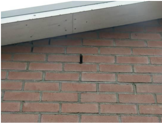
Afbeelding 5.3. Links boven: Impressie gebouw B. Rechts boven: Ruimte tussen het dak en de muur. Links onder: gat spouwmuur en ruimte tussen muur en dakbetimmering.
