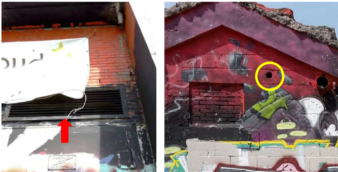
Figuur 3.1 en 3.2 Potentiële verblijfplaatsen van vleermuizen, bereikbaar via rooster (rode pijl) en gat (gele cirkel) in het tribunegebouwtje. Foto's: Arno Kuipers, Ecogroen.
